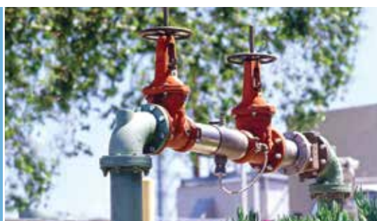
Blikkenslagerarbejde og flow-kontrol
